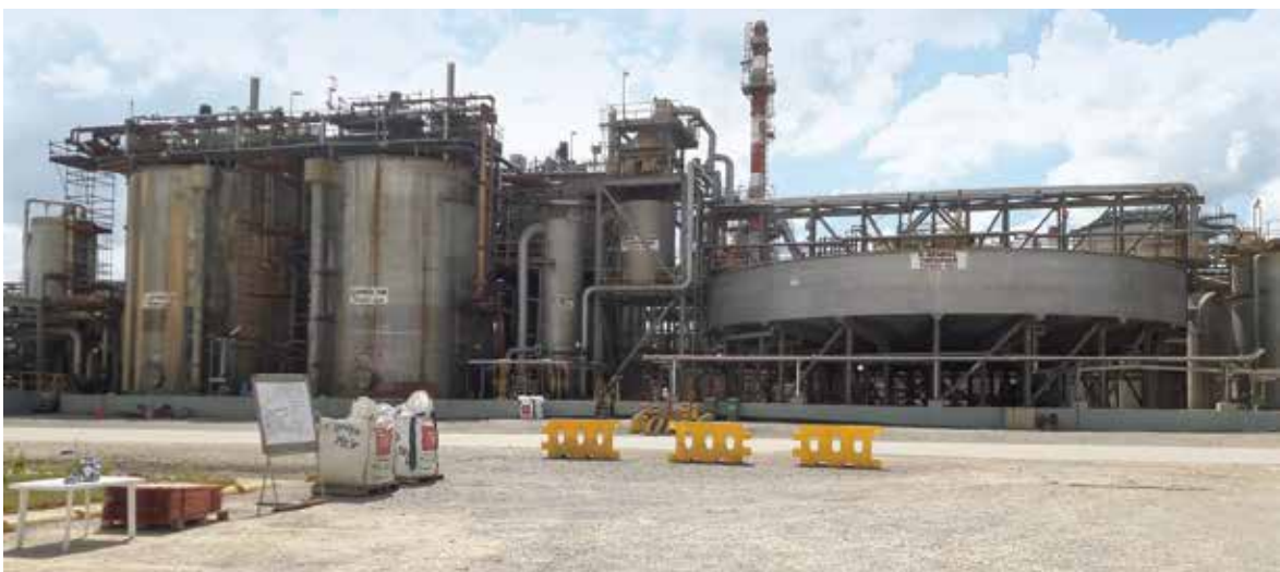
Abb. 53: Aufbereitungsanlage zur Herstellung von Kobalhydroxid bei Tenke Fungurume Mining Sarl (Foto: BGR 2018).
