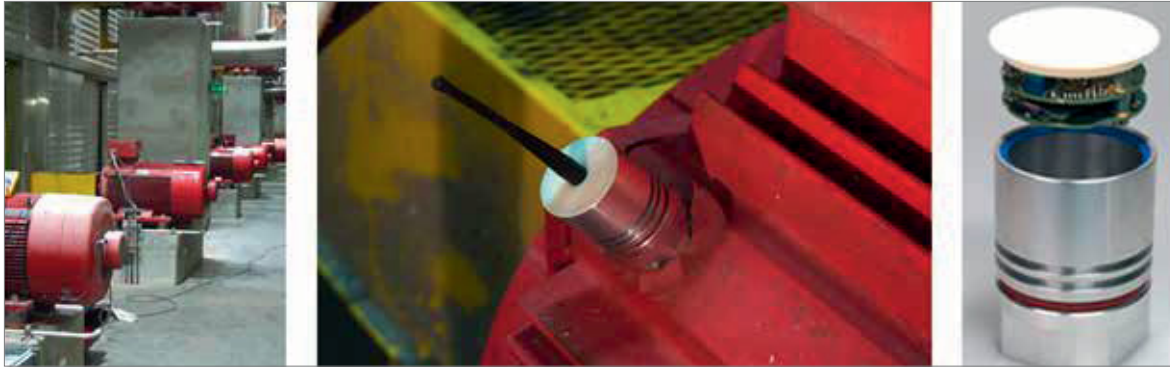
Abb. 4.77: Thermoelektrisch betriebenes Condition Monitoring System in der Anwendungsumgebung Papierfabrik (Quelle: NIEDERMAYER et al. 2014)
