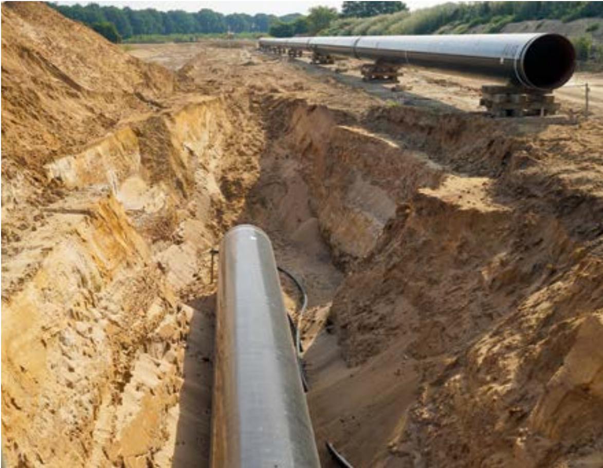
Unterirdisch verlegte Rohre, wie diese Erdgasrohre, werden zum Schutz vor abschließender Auffüllung des Grabens mit Sand ummantelt, Foto: Andreas Wittmar (mit frdl. Genehmigung).
