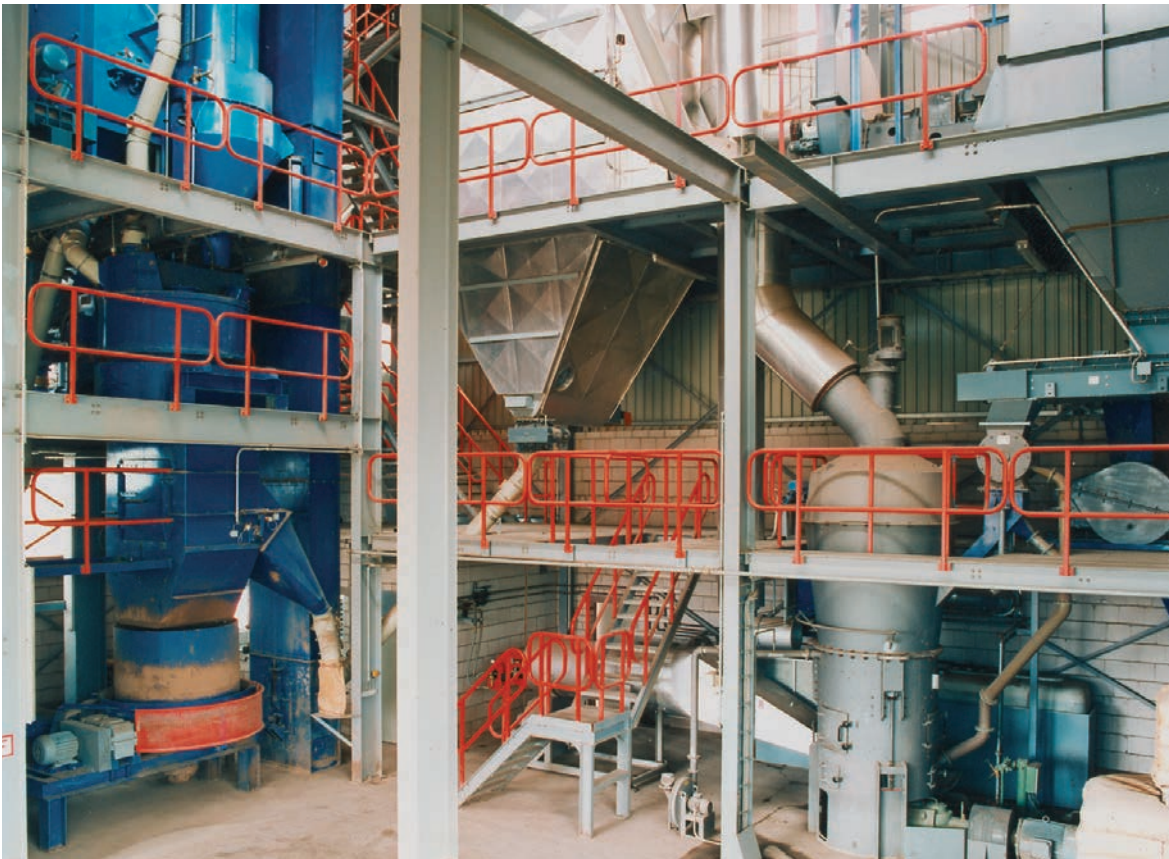
Im Werk Großheirath der Adolf Gottfried Tonwerke GmbH wird Ton bis kleiner 63 Mikrometer mahlgetrocknet und teilweise gemischt und granuliert, Foto: Adolf Gottfried Tonwerke GmbH (mit frdl. Genehmigung).
