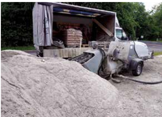
Estrichkies 0/8 mm, Zement und Wasser werden zumeist mit Hilfe einer Estrichpumpe vermischt und dann in Form von Fließestrich in den gewünschten Raum gepumpt, Foto: BGR.
