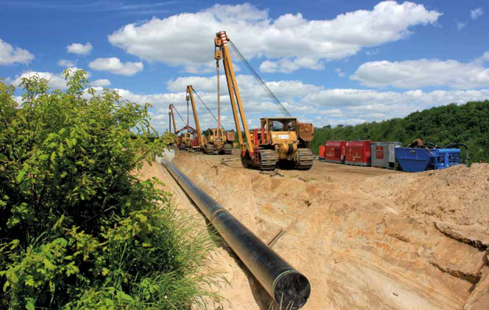
Unterirdisch verlegte Rohre, wie diese Erdgasrohre, werden zum Schutz vor abschließender Auffüllung des Grabens mit „Kabelsand“ 0/1 mm ummantelt, Foto: Andreas Wittmar (mit frdl. Genehmigung).
