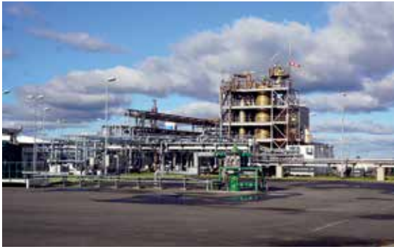
Blick auf die Erdgasförder- und -aufbereitungsanlage in Kietz/Brandenburg, Foto: Neptune Energy Deutschland GmbH (mit frdl. Genehmigung).
