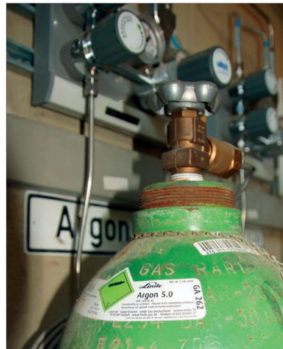
Abb. 34: Argon wird in Deutschland von mehreren Unternehmen, hier der Linde AG, angeboten, Foto: BGR.
