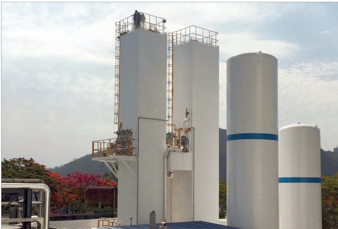
Abb. 48: Die Aufreinigungsanlage für Krypton und Xenon in Panzhihua, Sichuan Provinz, der Hunan Xianggang Messer, Foto: Messer Group GmbH (mit frdl. Genehmigung).
