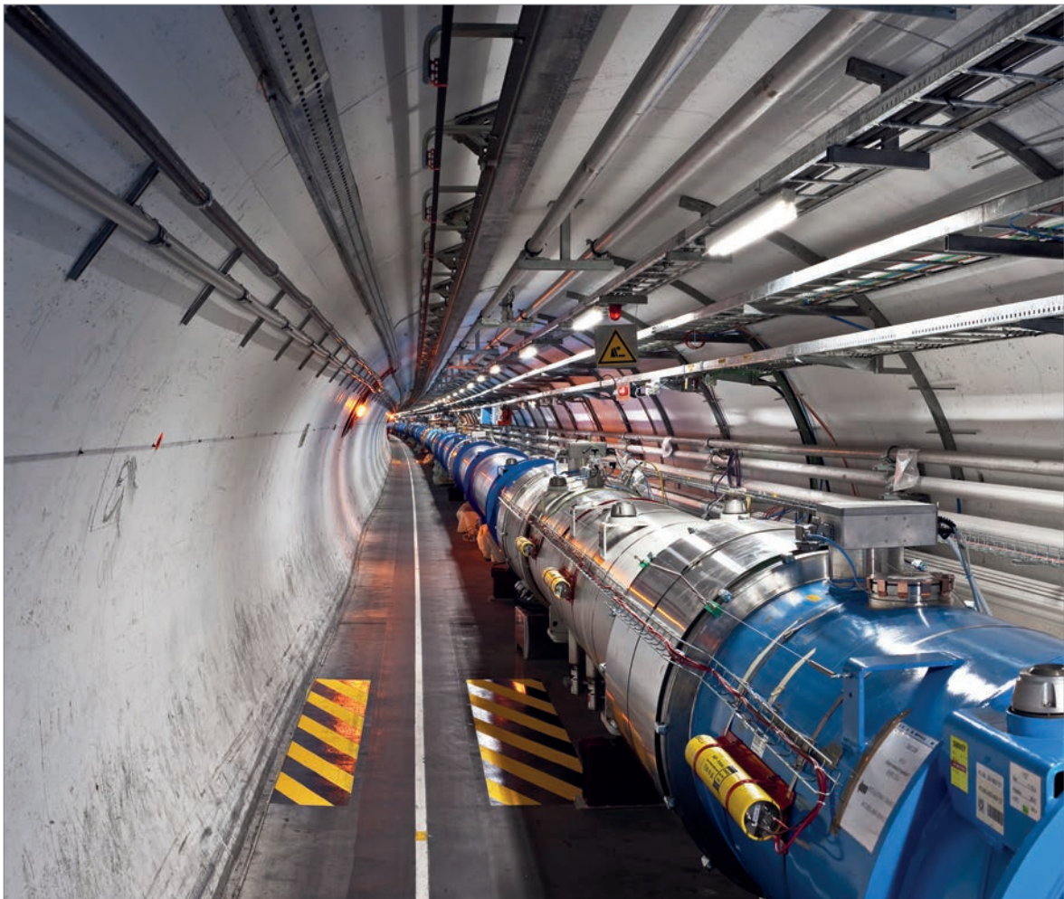
Abb. 10: Blick in einen Teilabschnitt des Tunnels des Großen Hadronen-Speicherrings LHC, für dessen Funktion eine ständige Tiefkühlung der Magnete mittels flüssigem Helium notwendig ist, Foto: Maximilien Brice, CERN.
